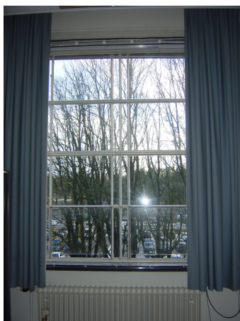
Figuur 6: Voorbeeld van een proefopstelling van een klimaatgevel (overdruksysteem, mechanische toevoer en natuurlijke afvoer via de spouw) bij een monument, de Politieacademie in Apeldoorn waar stalen ramen zijn toegepast. De U-waarde van het raam is vergelijkbaar met die van blank dubbel glas.
